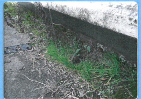
排水口を植物が塞いでいる
